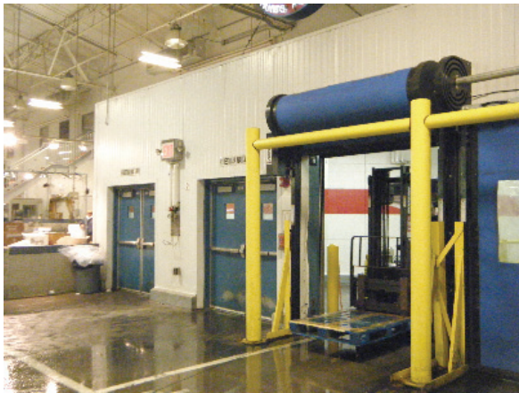
図Ⅶ.7-8 リフト用通路はシャッター式 歩行者用通路は手押し扉
